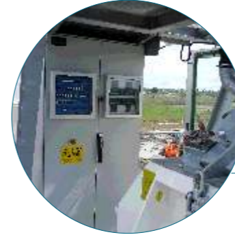
Armoire électrique de la centrale
